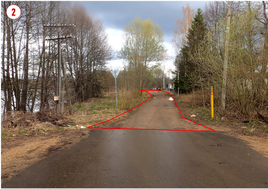
Отсутствие твердых покрытий на проезде и парковке
